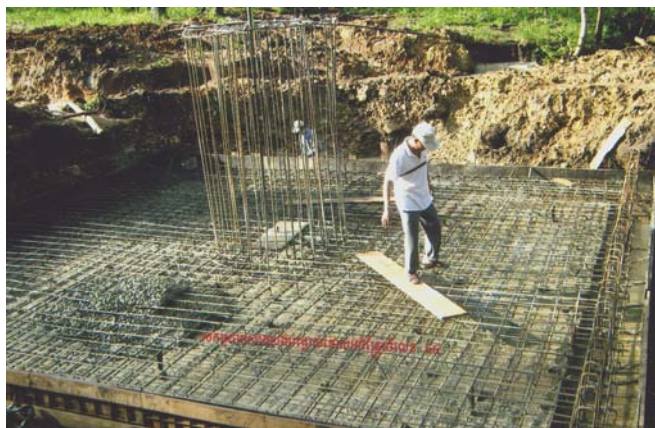
Travaux de préparation du fondement de la borne frontière n° 44 dans la province de Mondolkiri- Daklac
